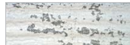
Разрушение лакокрасочного покрытия, нанесённого вручную
